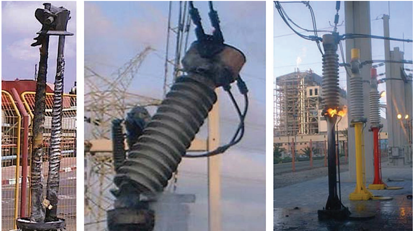
Рис. 2. Повреждения ТТ в результате накопления газов под действием частичных разрядов [2].
