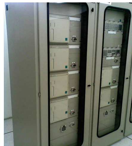
Рис. 4. Современный способ монтажа МУРЗ в релейных шкафах.
