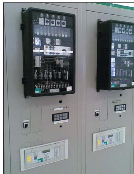
Рис. 17. Фрагмент панели дистанционной защиты ответственных линий 160 кВ, содержащей электромеханические реле типа LZ31 (вверху), включенные на параллельную работу с микропроцессорными защитами типа MiCOM P437 (внизу)
