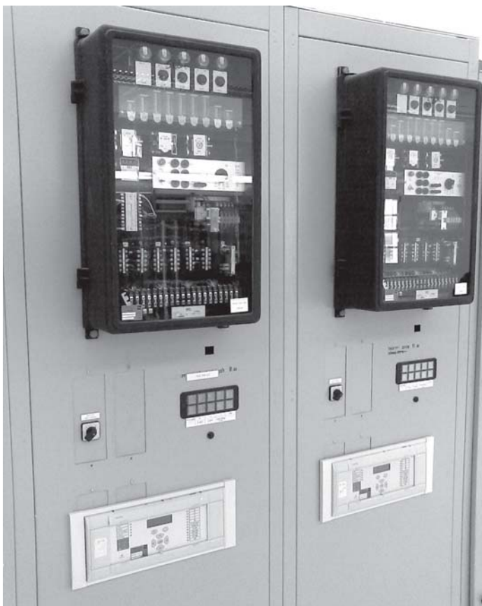
Рис. 1. Фрагмент панели дистанционной защиты ответственных линий 160 кВ, содержащей электро-механические реле типа LZ31 (вверху), включенные на параллельную работу с микропроцессорными защитами типа MiCOM P437 (внизу)
