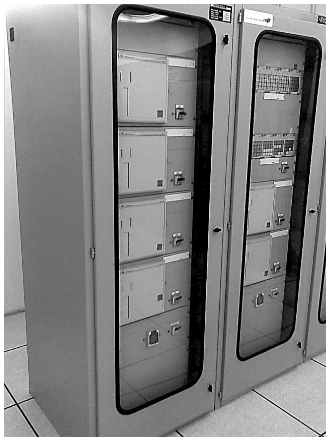
Рис. 2. Современный способ монтажа МУРЗ в шкафах
